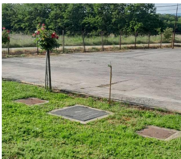
Slika 7. Separator ulja i masti
