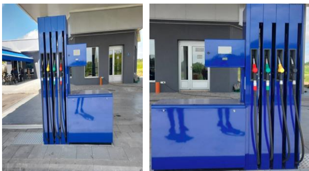
Slika br. 6. Pumpni agregat 3,4 sa 4+4 pištolja
