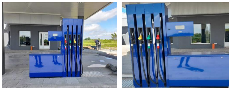
Slika br. 5. Pumpni agregat 1,2 sa 4+4 pištolja
