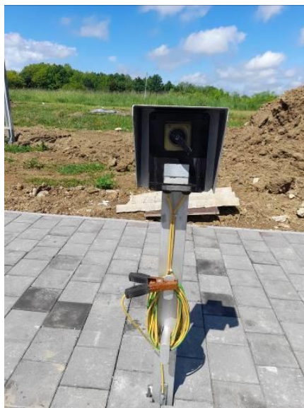
Slika br. 7. Prekidač za uzemljenje autocisterne
